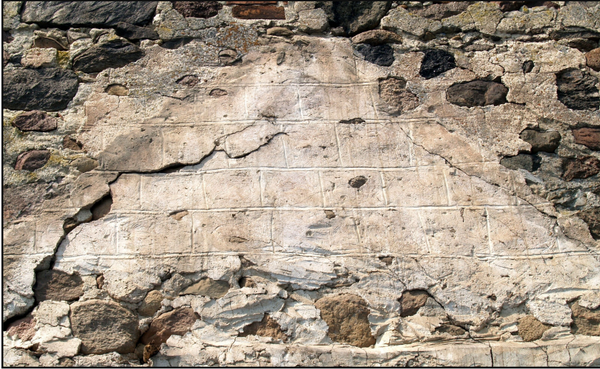
Kirche in Kirch Polkritz. Romanischer Putz unter dem abgenommenen Apsisdach. (Foto: Verfasser, 2011)
